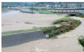
▲平成30年7月豪雨 広島県安芸郡熊野町の被害
